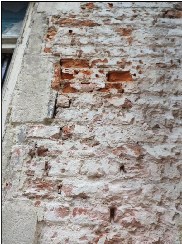
Figuur 4. Onvoldoende onderhoud van een beschermingslaag tegen slagregen (Klooster van de Rijke Klaren, Brussel)
