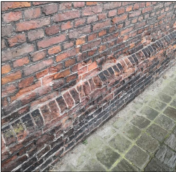
Figuur 2. Verhoogd risico op vorstschade (opstijgend vocht ter hoogte van de plint) (Sint-Godelieveabdij, Brugge)
